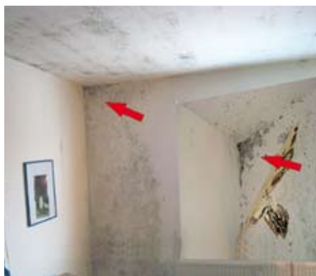
Zimmer im 2. OG zum ungedämmten Dachboden März 2009
