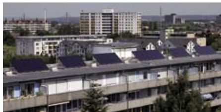
Die thermische Solaranlage in der Brüsseler Str. 9 in Bonn
