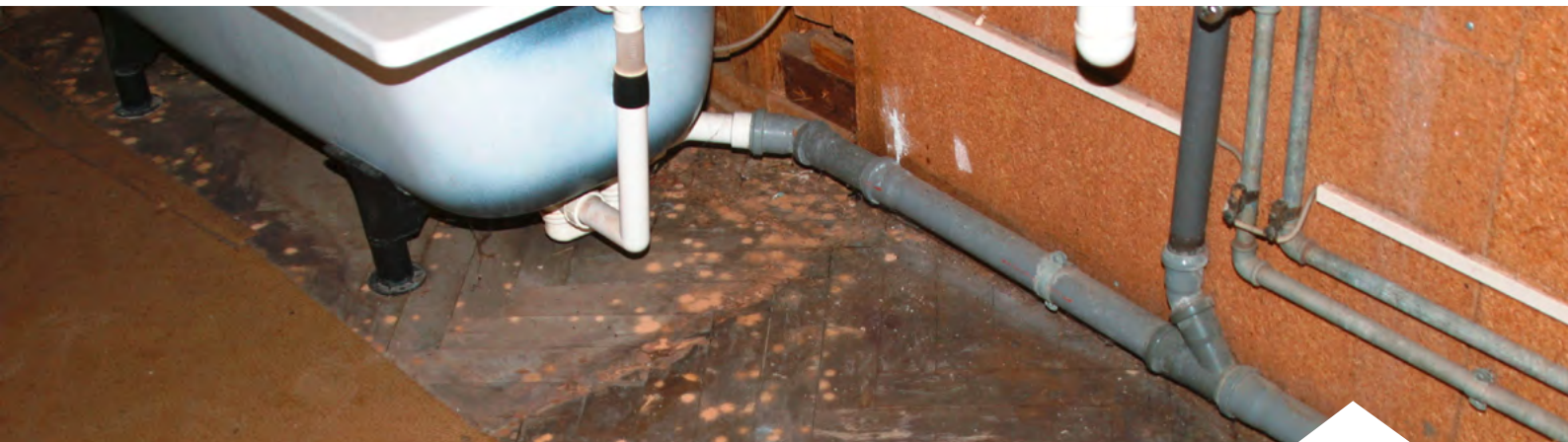
Abb. 6: Frische Bohrmehlhaufen in einem Bad deuten auf einen aktiven Befall hin.
