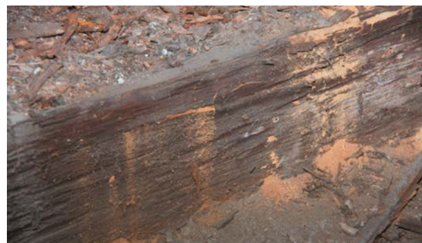
Abb. 4: Ovale Fluglöcher und ausgeworfenes Bohrmehl vom Hausbock
