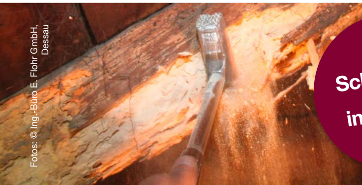
Abb. 1: Massive Zerstörung eines Sparrens durch den Hausbock
