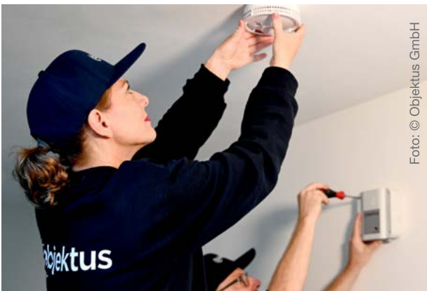
Die Installation von Rauchwarnmeldern birgt Tücken. Spezialisierte Anbieter wie Objektus berücksichtigen potenzielle Störfaktoren und beugen damit Fehlalarmen vor.
